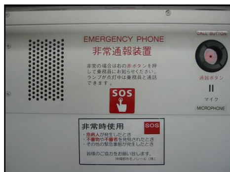
車椅子スペース部 非常通報装置
