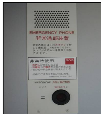
車両連結部 非常通報装置
